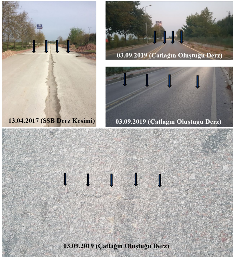
Şekil 6. İlk yansımaya çatlağının oluştuğu yer
