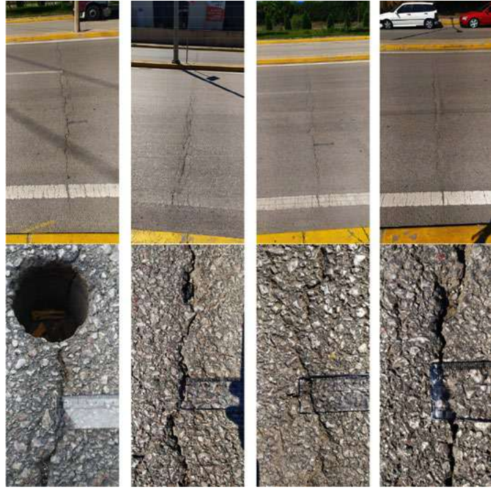
Şekil 8. Yansıma çatlaklarının yerinde incelenmesi (2022)
