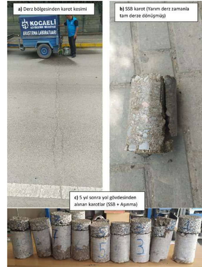
Şekil 9. Kaplama gövdesinden alınan karot numuneler (2022)
